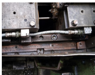
Třísosé senzory vibrací na nástroji horizontálního lisu. Kabeláž je chráněna krkem s nerezovým opletem. To zvyšuje odolnost proti okujím a vysokým teplotám.
